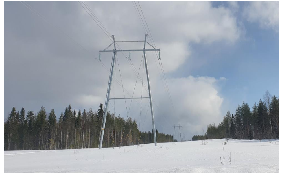
Kuva 8. Esimerkki 110 kV -voimajohtojen maastokäytävästä. ©Sweco.
